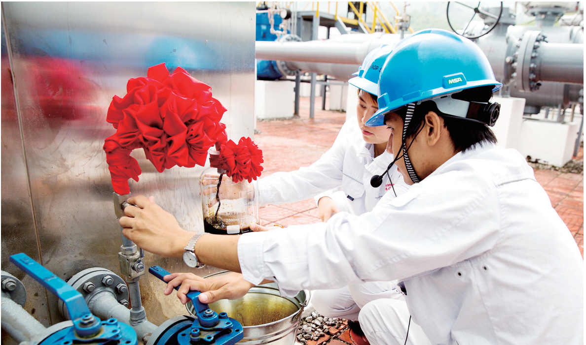
缅甸当地时间5月19日10时10分，中缅管道南坎原油计量站采样显示，原油纯油头已经顺利到达该站。这标志着中缅原油管道（缅甸段）投产成功，中缅油气管道项目进入新的历史阶段。图为工作人员在缅甸南坎进行原油采样。
