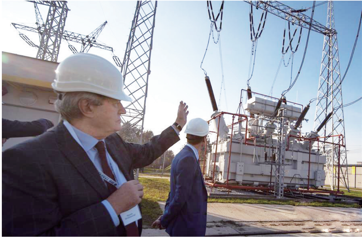
由中国平高集团有限公司承建的波兰科杰尼采变电站扩建及改造项目日前在波兰东部城市科杰尼采举行竣工仪式，该项目是中国在欧盟国家完工的首个输变电工程总承包项目。图为波兰员工介绍刚刚完成扩建改造的科杰尼采变电站的新设施。
