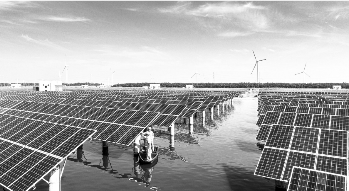
近年来，江苏省海安市老坝港滨海新区积极推进新能源结构调整，培育壮大新能源产业，利用滩涂资源打造高科技、高性能、生态环保可持续发展的光伏项目，推动地方经济绿色发展。图为滩涂上的海东光伏电站工作人员正在检查光伏发电设施。
