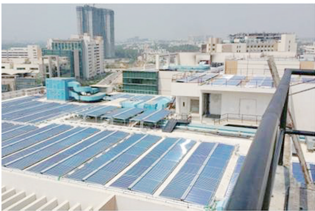
力诺瑞特承建的印度IBM工业园太阳能空调项目
