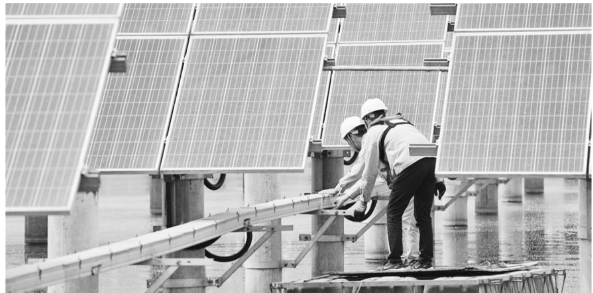
河北省唐山市丰南区通威“渔光一体”现代渔业产业园总体规划面积12000亩,该项目一期工程于2018年底并网发电,完成鱼池标准化改造3000余亩,在产生清洁能源的同时,依托“公司+基地+农户”的产业化经营模式推广高效养殖,每亩综合效益超5万元,有效提高养殖户收益。图为工人检修光伏发电设施。新华社记者 牟宇 摄
