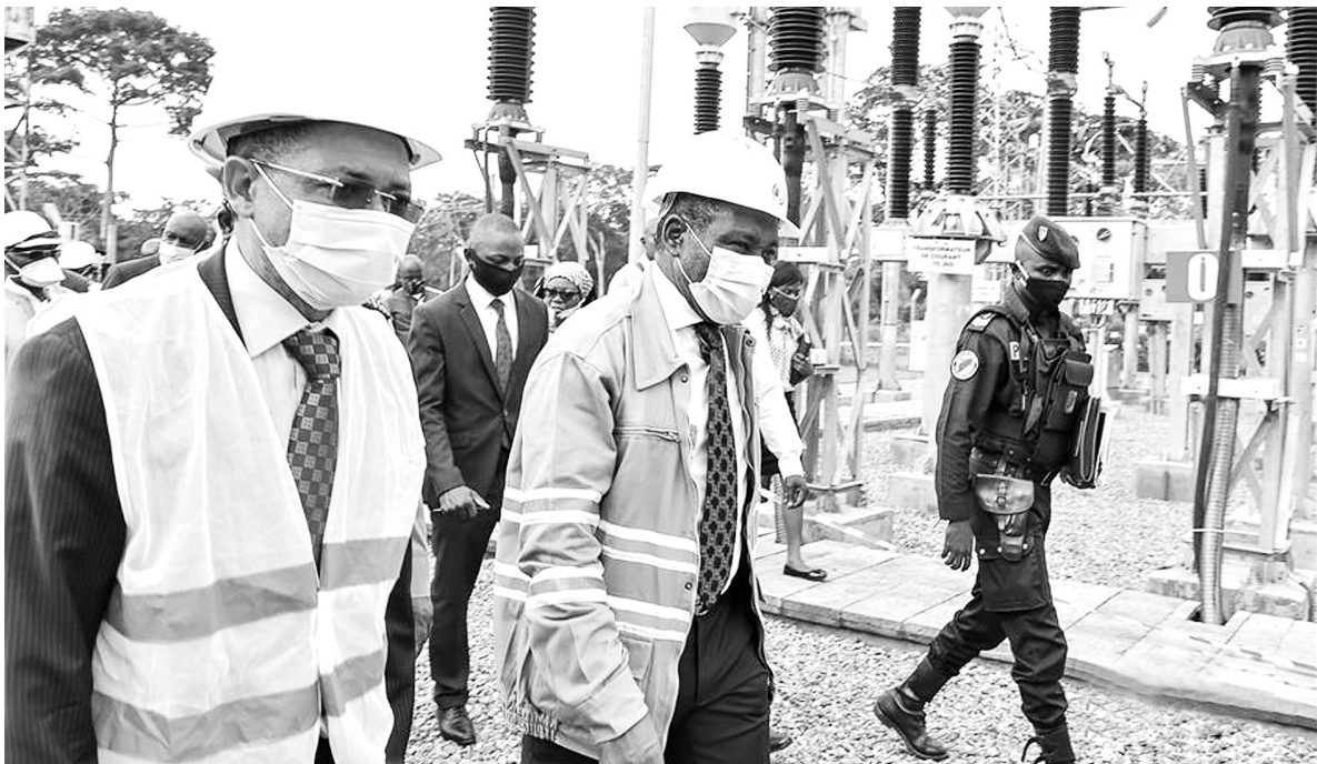
喀麦隆水资源和能源部长埃伦杜·埃坎巴日前对中喀企业协作扩大喀麦隆曼维莱水电站输出功率从而降低喀发电成本表示感谢。据悉,该项目由中国电建、喀麦隆国家输电公司、喀麦隆电力发展公司等协作完成,将曼维莱水电站输出功率从45兆瓦扩充至92兆瓦。
