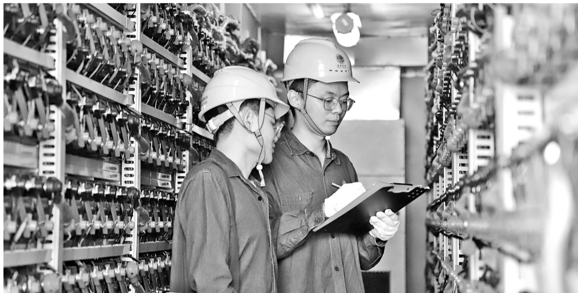
上虞源网荷储微电网示范站位于曹娥江畔,是国内首个用户侧商业化运营的项目。该站自建设落地以来,实现了高密度可再生能源的高效利用和交直流负荷的高可靠性供电,有力提升了中国在微电网领域的国际竞争力。据悉,该项目年均光伏发电量约230万千瓦时,节省用电成本160余万元,助力碳达峰、碳中和。图为6月5日,国网绍兴市上虞区供电公司职工正在检查储能装置。中新社发 丁琦摄
