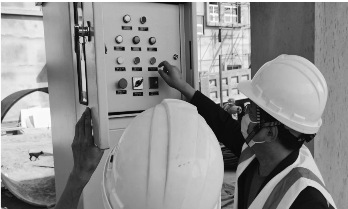
由中国企业承建的孟加拉国达舍尔甘地污水处理厂项目近日顺利通污水,标志着项目进入试运行阶段。图为工作人员在该污水处理厂主厂区开启闸门进污水。
