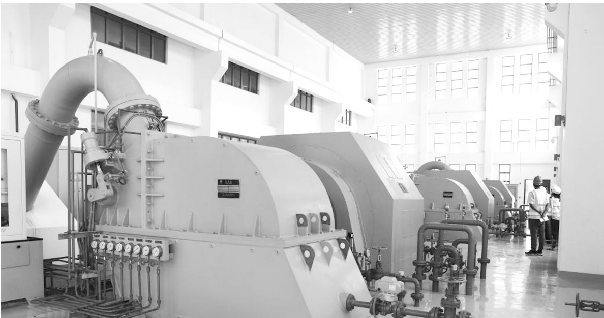
中国援建的布隆迪鲁巴齐水电站最后一台机组于今年7月完成试运行,电站三台机组当月实现并网发电目标。该水电站的建成对提高当地工业生产水平、促进国民经济发展、改善居民生活水平等起到重要作用。图为鲁巴齐水电站发电机组。
